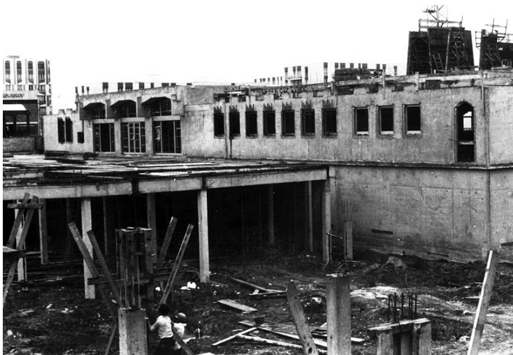
La construction de la Poste dans le centre-ville, fin des années 1970. © Photothèques des Ulis/Ville des Ulis.
